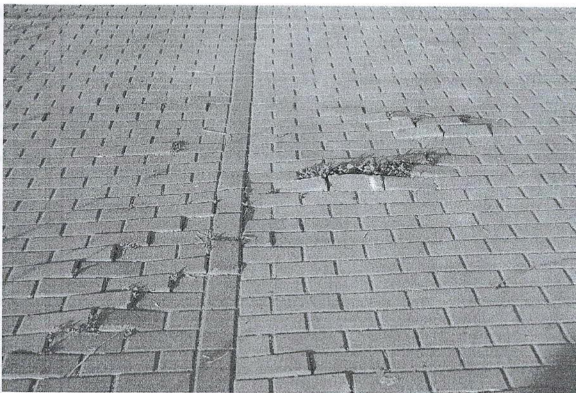
Rysunek 4. Nawierzchnia ciągu pieszo-rowerowego wzdłuż DK 13 po trzech latach od oddania do użytku.
