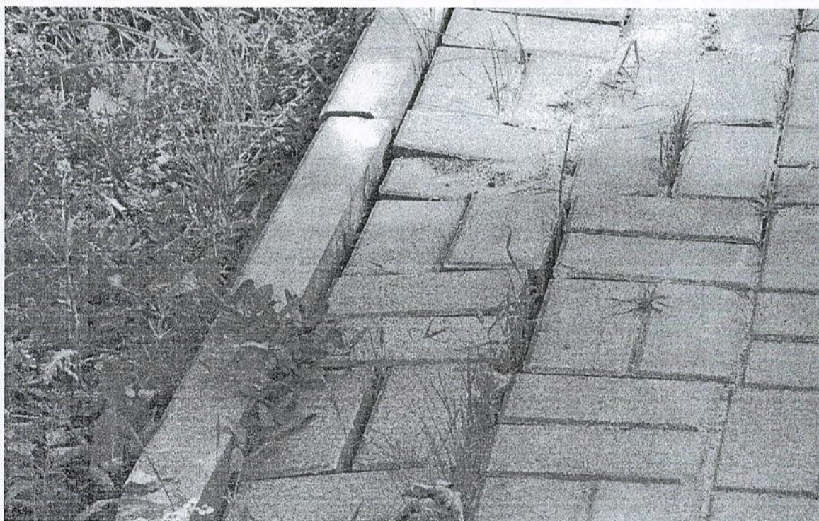
Rysunek 6. Tak często w praktyce wygląda odtworzenie nawierzchni z kostki betonowej po zakończeniu robót. DK 2 w okolicy Błonia.
